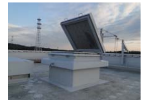
1号機トップベント設備
