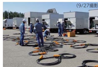
電源車操作訓練
