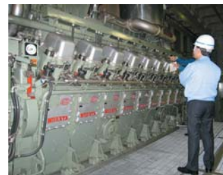
非常用発電機 (イメージ)
