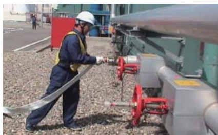
消防ホースの注水ライン接続
