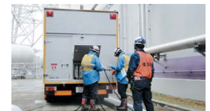
電源車による代替電源
