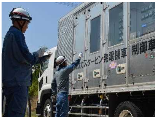
電源供給訓練
