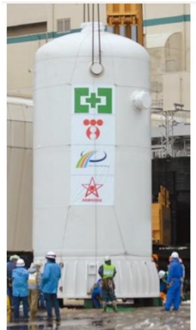
放射性物質を除去する フィルタベント装置
