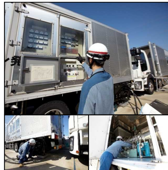
ガスタービン発電機起動訓練の様子
