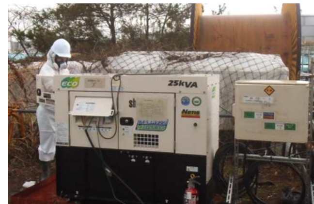
仮設発電機の接続・作動訓練 （福島第一）
