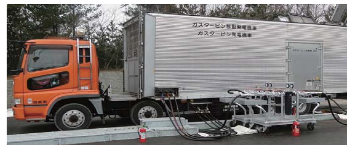
空冷式ガスタービン発電機車の高台配置
