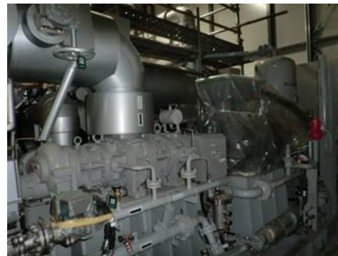
写真①：冷凍機設置完了・試運転待ち
