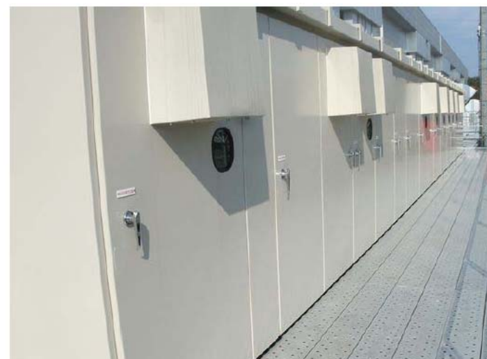
新事務棟高圧受変電設備（全体写真）
