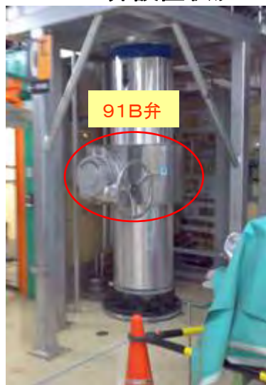
91B弁設置状況
