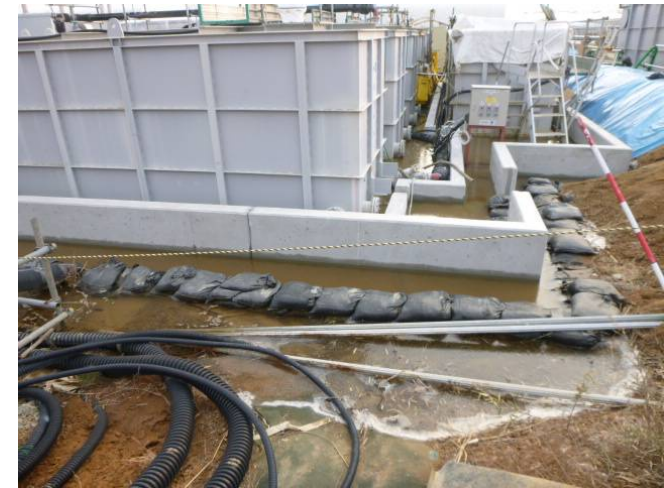
漏えいの状況（①エリア）
