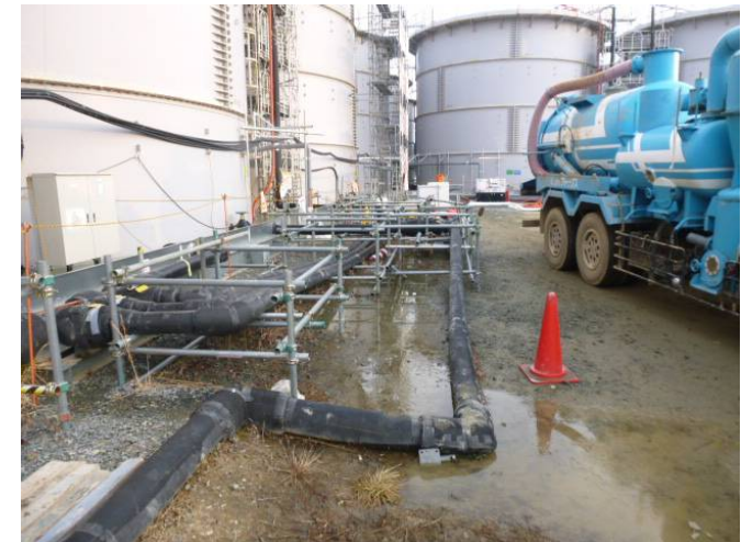
漏えいの状況（③エリア）
