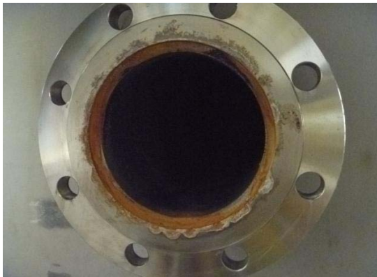
すき間腐食が確認されたフランジ例
