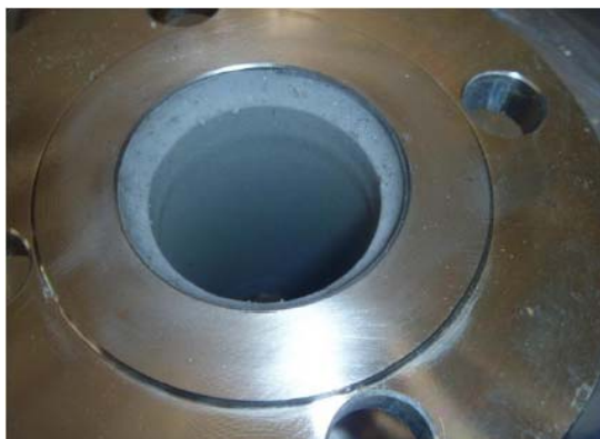
すき間腐食が確認されなかったフランジ例
