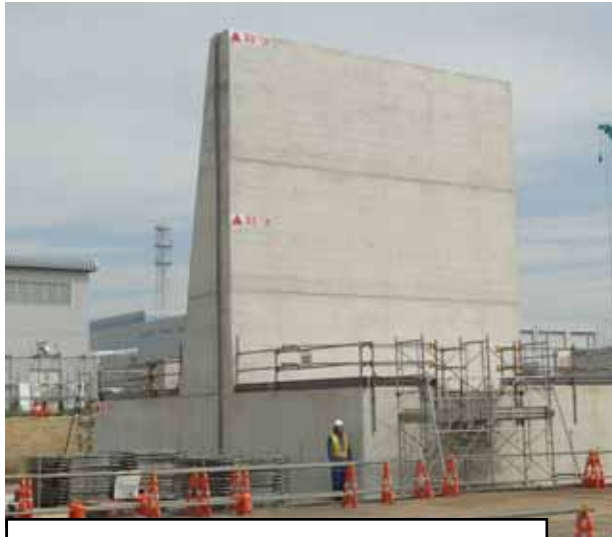
防潮堤：敷地内への浸水を防止
