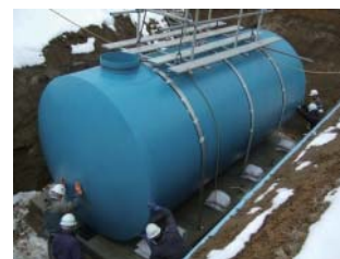
耐震防火水槽
