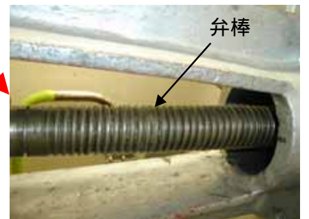
3号機残留熱除去系弁熱交換器(B)入口弁の不具合概略図
