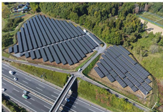
谷向太陽光発電所
