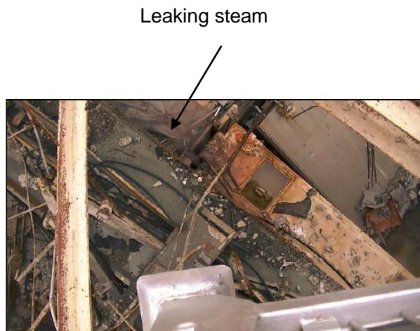
撮影者：東京電力株式会社 撮影日：平成23年8月24日
