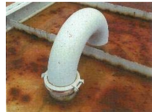
D1 tank ventilation tube
