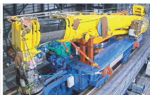
2号機の燃料取り出し用構台へ設置された「燃料取扱設備」(5月30日撮影)
