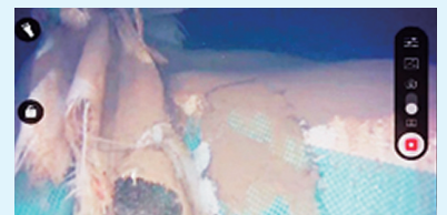
破損している土嚢(2019年調査時)
