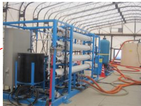
淡水化装置（RO装置）
