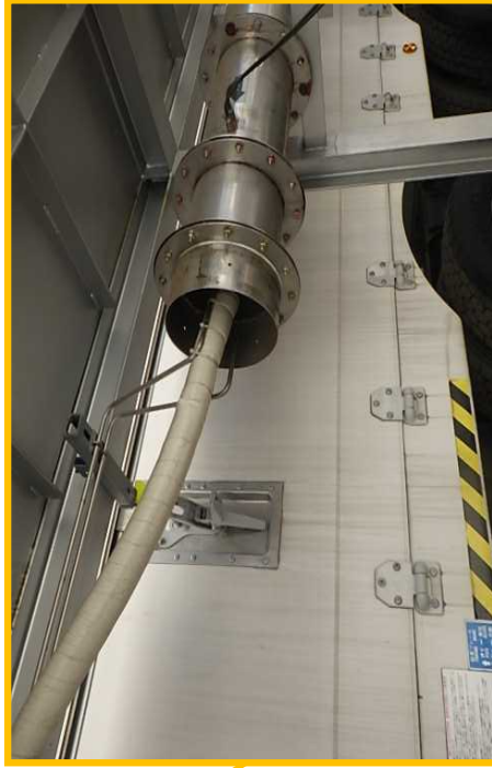
油処理装置 排気口
