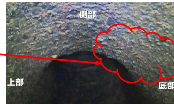
減肉傾向箇所の内部（底部側）
