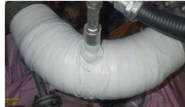
止水テープ施工後の熱交換器（B）出口配管 （撮影日：4月11日）
