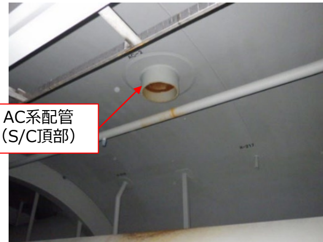
(参考) 5号機AC系配管のS/C突き出し状況
