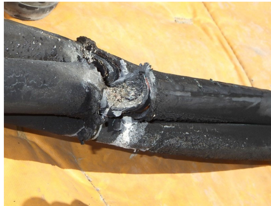
損傷したケーブルの状況 (撮影日：2024年9月12日)
