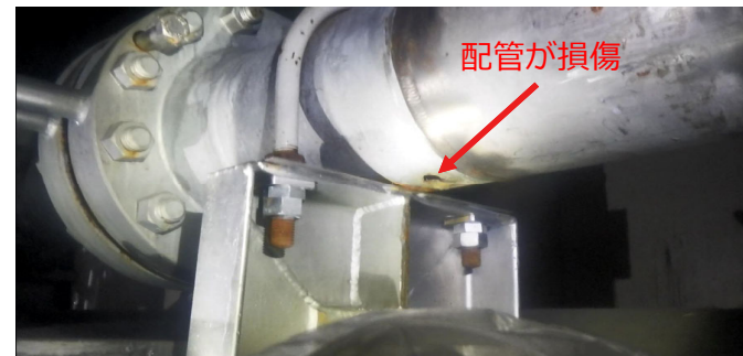
FPC熱交換器室内の配管の状況（10月2日調査時：作業員撮影）
