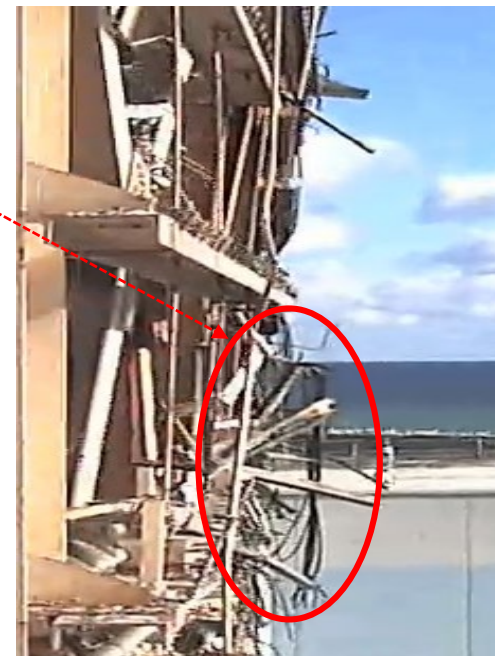
鉄骨鋼材・電線管のはみ出し状況
