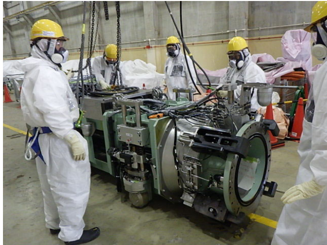
堆積物除去装置（低圧水）外観
