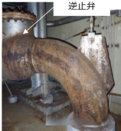
既設CUWライン (水位計取付箇所)
