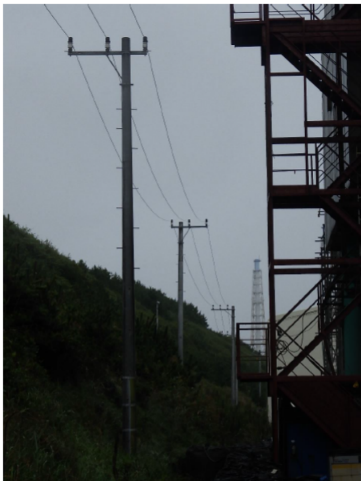
(参考) バッチャープラント キュービクル送電ライン
