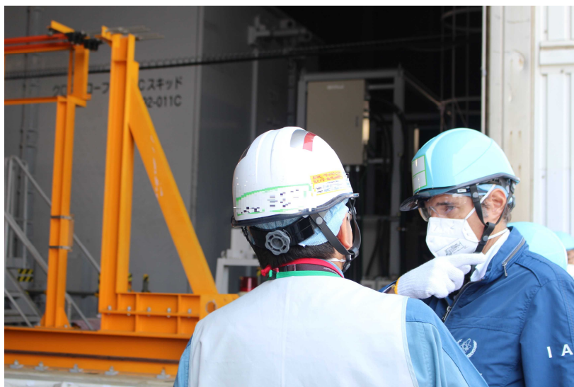
増設多核種除去設備（増設ALPS）
