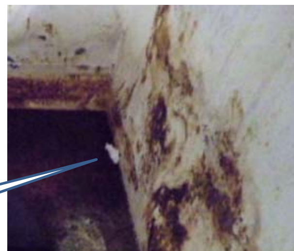
写真2.コンテナ内面・補修箇所の状況
