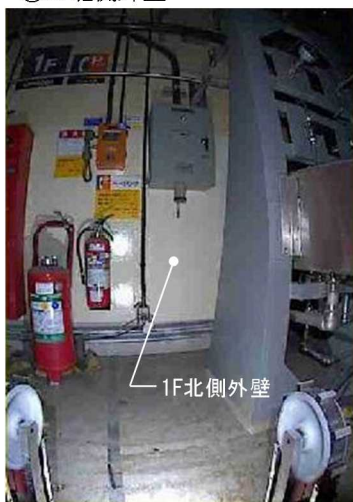
①1F北側外壁
