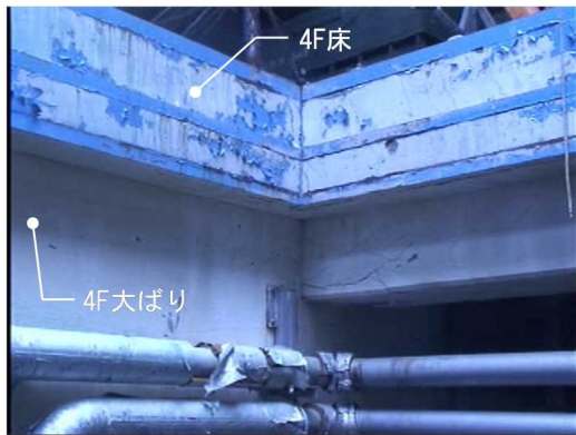
①4F大ばり交差部（R5通り×RF通り）
