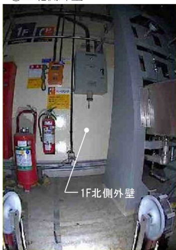
①1F北側外壁
