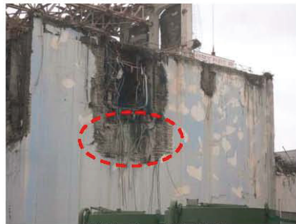
④外壁一部剥落
