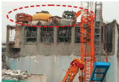
オペフロ上部の機器 [西面] 撮影日：平成 24年 7月 9日
