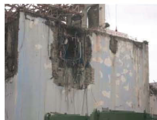
④外壁一部剥落
