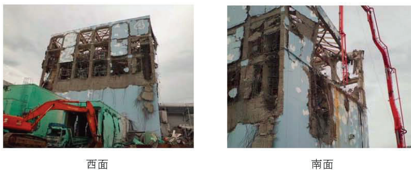
図2 西面・南面の損傷状況 (5月10日撮影)
