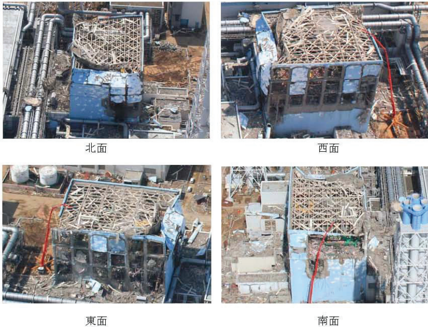
図1 損傷状況 (3月24日撮影)
