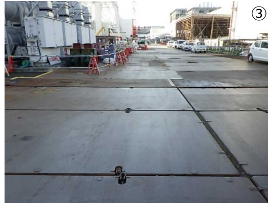
2号機側から3号機側 (フェーシング上に 鉄板敷設。(2024.2月完了予定)
