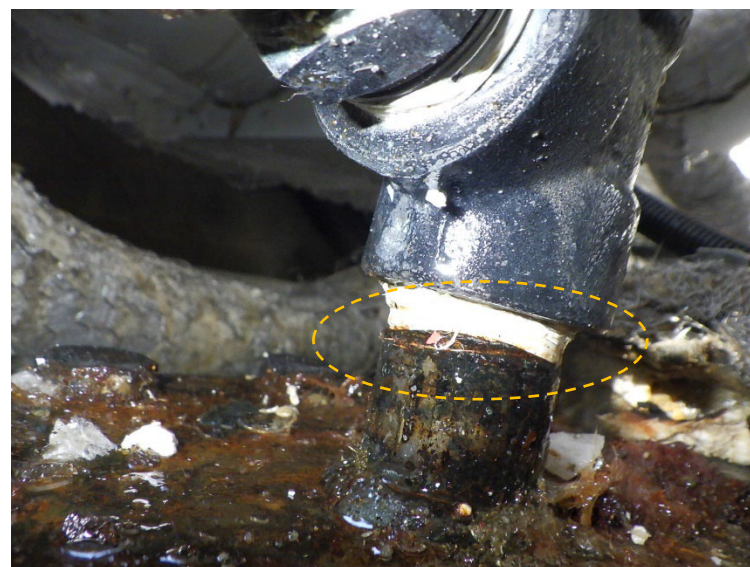
凍結管継手部 漏えい箇所
