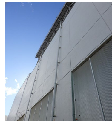
雨水排水設備
