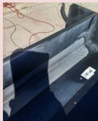
塗装剥離後の一例
