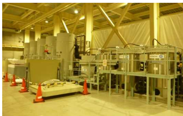
③サブドレン他浄化設備
