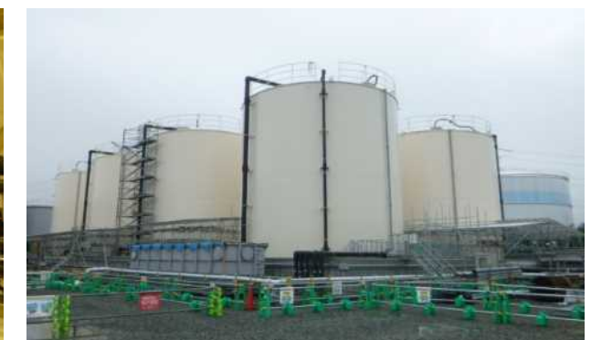
④一時貯水タンク (7基)
