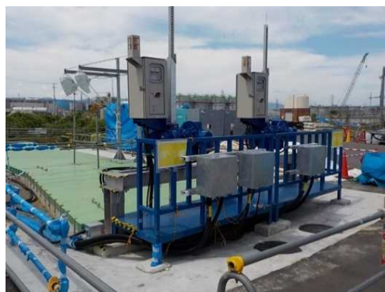
<BC排水路ゲート弁電動化>
