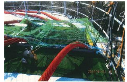
ハッチ開口部転落防止措置
