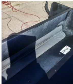
塗装剥離後の一例
