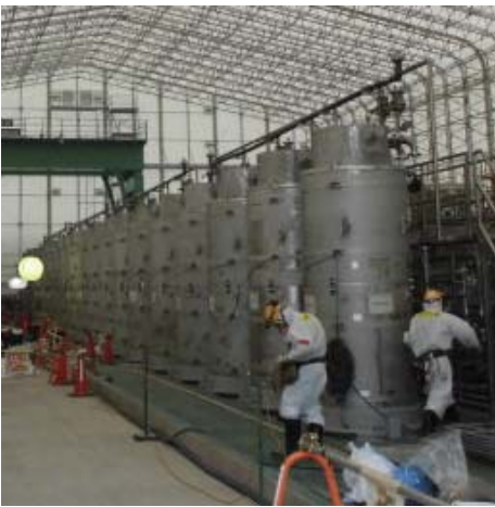
高性能多核種除去設備吸着塔
