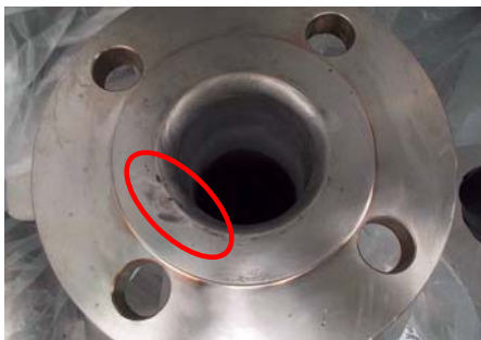
②吸着塔2C出口弁フランジ（上流 弁側）の腐食の様子
