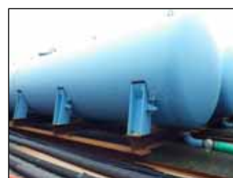
鋼製横置きタンク
