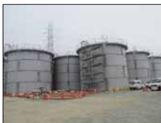
鋼製円筒型タンク
