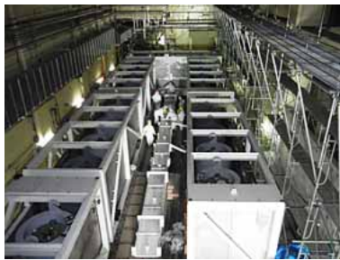
全体写真（スキッド（箱）の中に吸着塔（ベッセル）が入っている）
