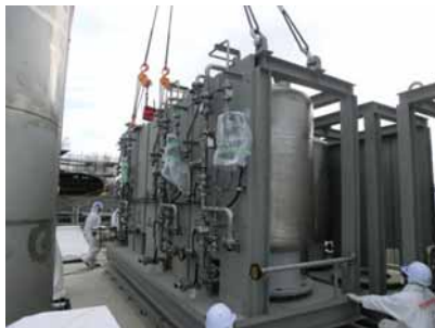
吸着塔（吸着材交換式）
