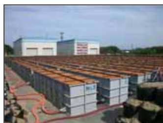
鋼製角形タンク
