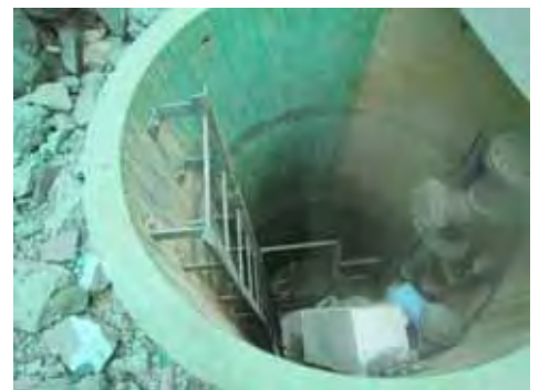
サブドレンピット内部（事故後）
