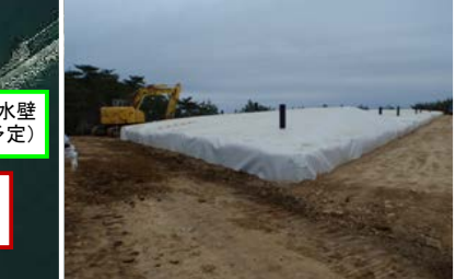
伐採木一時保管槽
