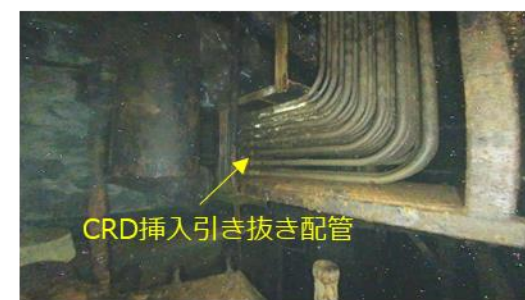
③：CRD挿入引き抜き配管(南西)
