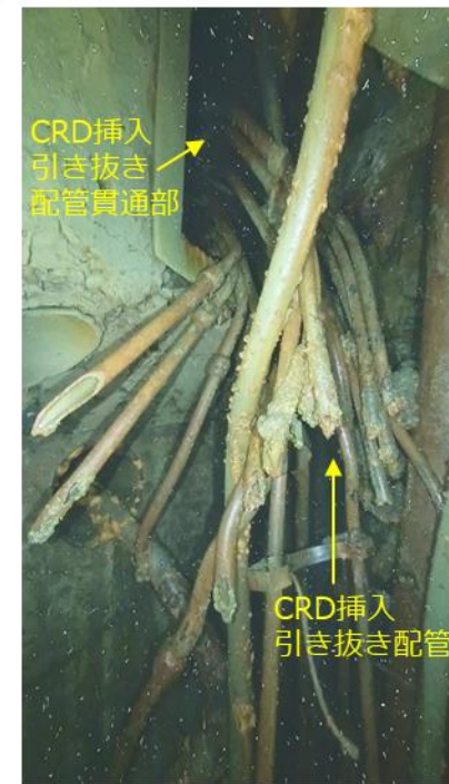
③：CRD挿入引き抜き配管(南東)
