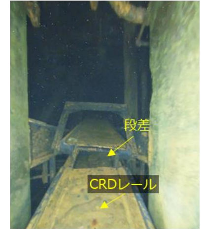
④：CRDレールの段差箇所
