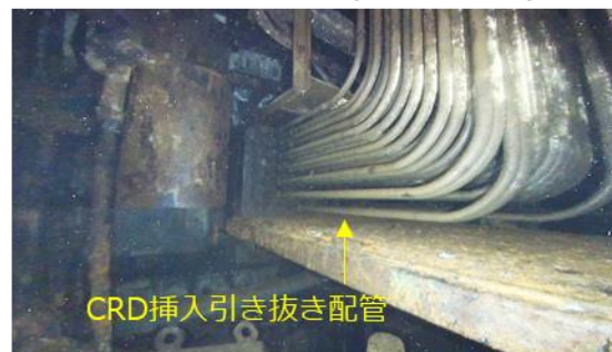
②：CRD挿入引き抜き配管(北東)
