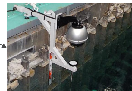
水位監視カメラ
