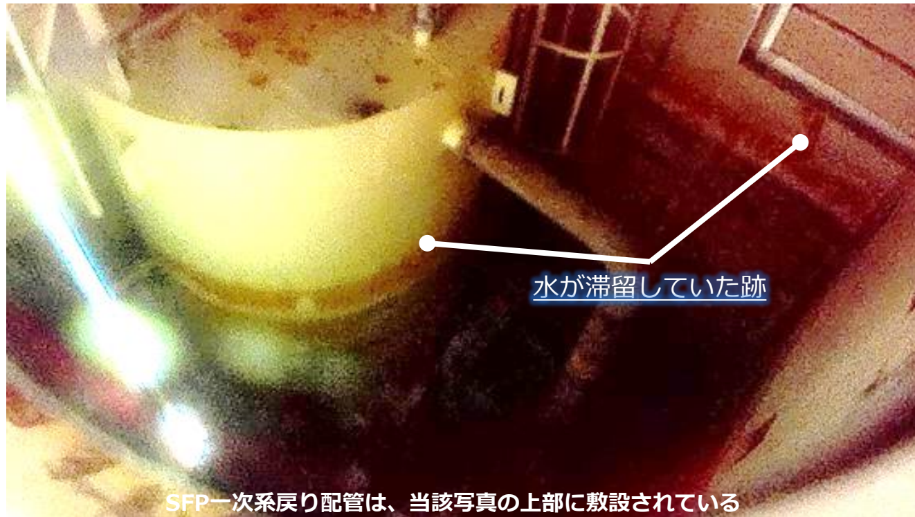
廃スラッジサージタンク室内状況
