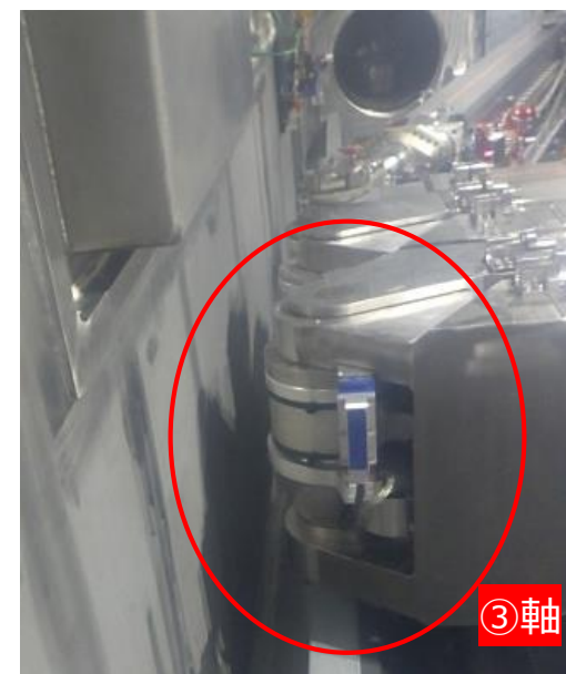
エンクロージャ内確認状況
