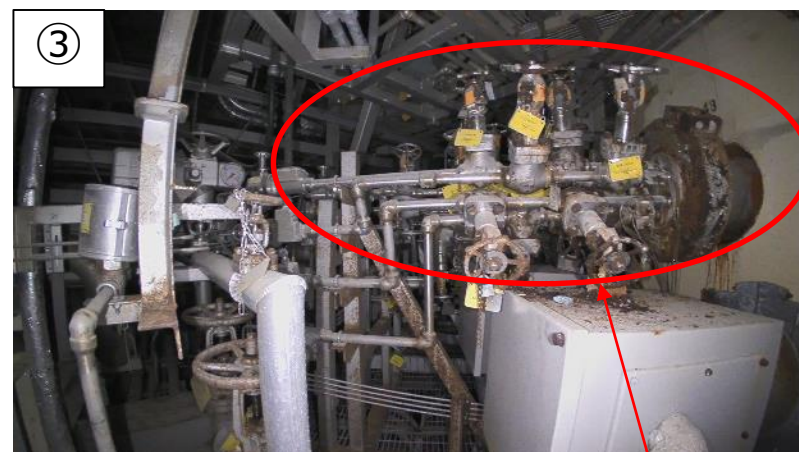
③ 再循環ポンプ計装ライン
