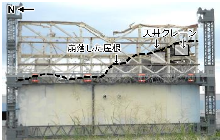
1号機を西から見た写真（ガレキの状況）
